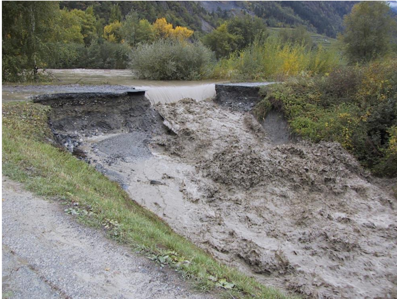
Alte und brüchige Dämme
