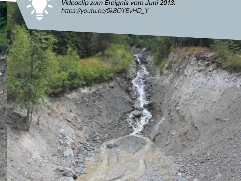
18.06.2013: Normalzustand des Sammlers nach der notfallmässigen Entleerung.
